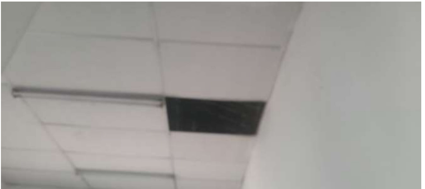
Cielo raso de la oficina en regular estado requiere mantenimiento
