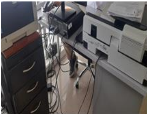
Oficina ventanilla única (Cables sueltos)
